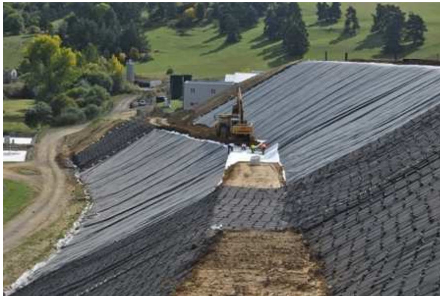
Figure 48 : Géotextile de recouvrement et puits de collecte du biogaz sur les casiers de l'ISDND des Cramades (source : SYTEC)
